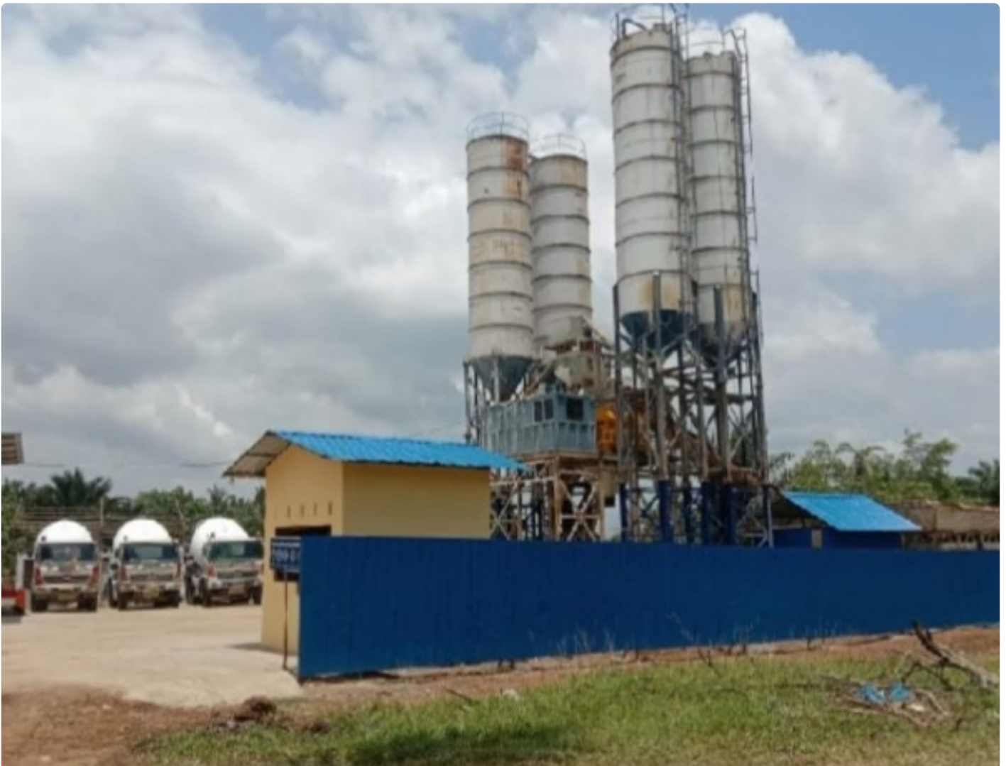
Batching Plan, Pengolahan Cor Beton Milik Rekanan PT PP di Nagori Huta Parik, Kecamatan Ujung Padang, Kabupaten Simalungun
